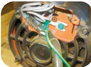
Ponto de aterramento existente no motor
